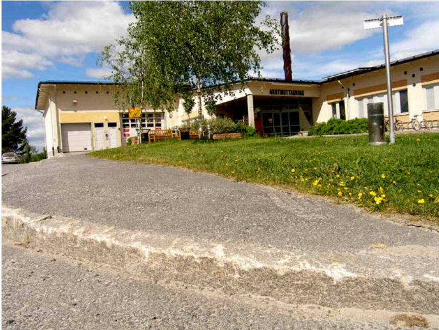
Hög kant vid gångpassage nära Sollefteå sjukhus
